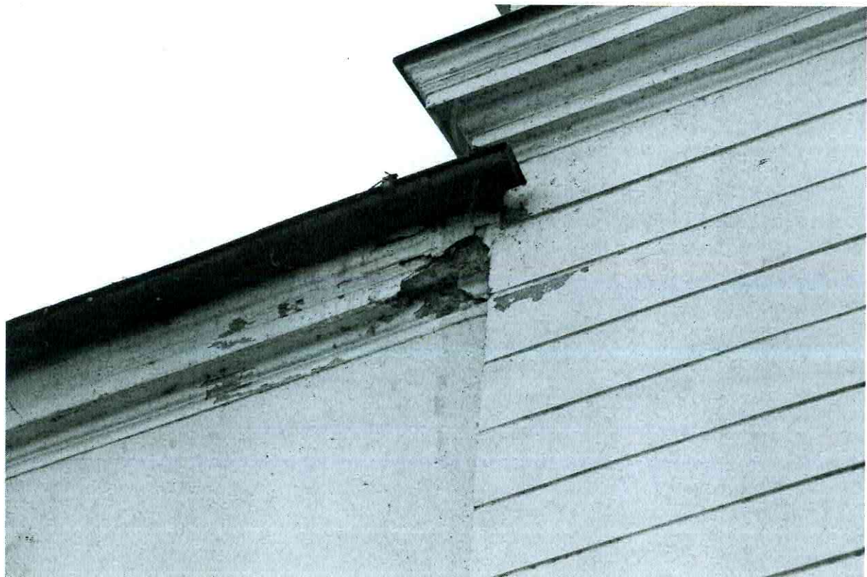
uszkodzenia przy balkonie
