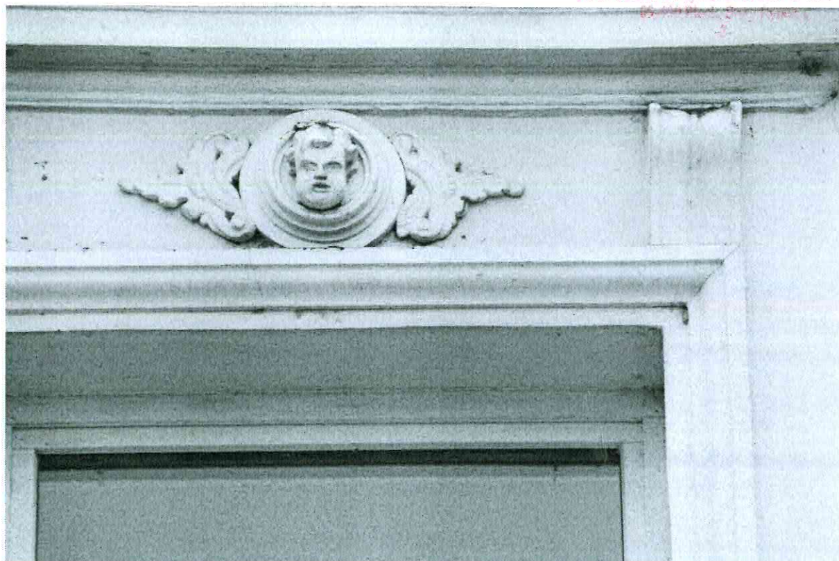
wsporniki balkonu- stan dobry
